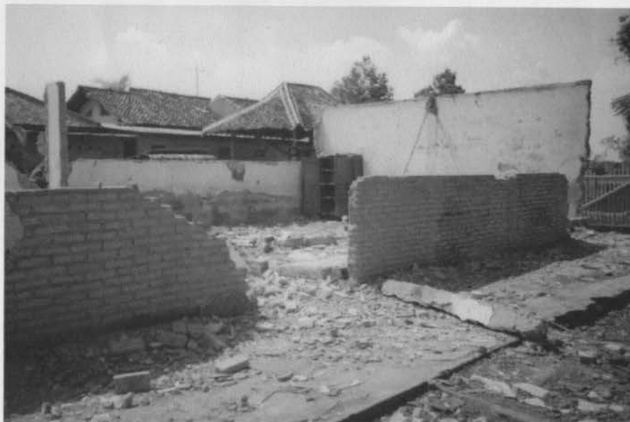
Salah satu gedung sekolah yang memerlukan rehabilitasi
