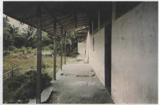
Lantai beton luar ruangan yang rusak maupun retak
