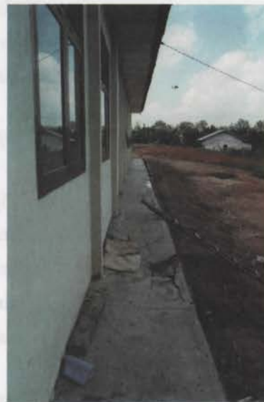
Paving block yang mengalami penurunan
