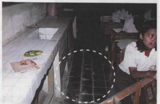
Lantai yang mengalami penurunan (dilatasi)
