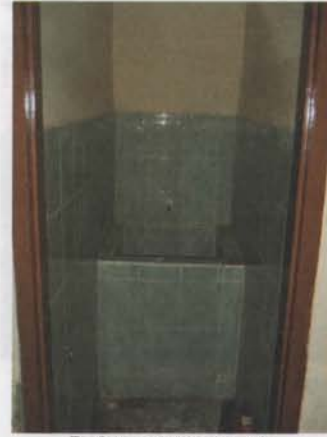
Bak penampungan air
