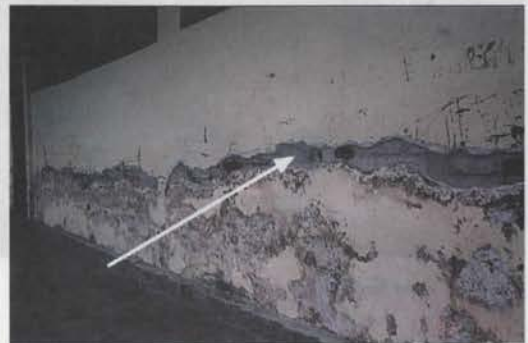
Retakan dan noda kelembaban pada dinding
