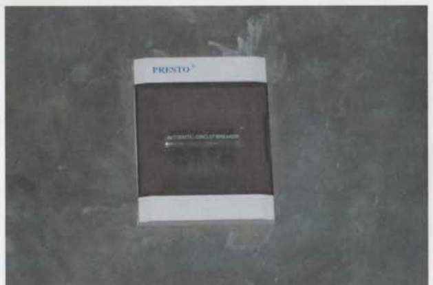
Sekering listrik pada dinding
