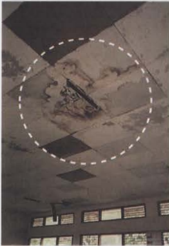
Noda-noda lembab yang timbul pada langit-langit ruangan akibat kebocoran pada atap
