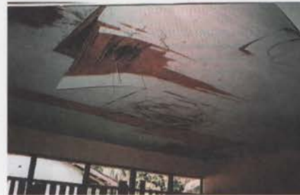
Langit-langit (plafond) yang mengalami kerusakan
