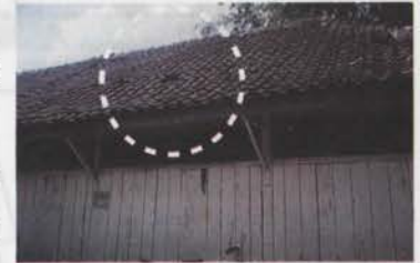
Susunan genteng yang sudah mulai bergeser/ hilang
