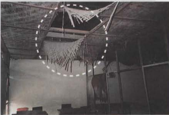
Panel langit-langit yang runtuh dan perlu diganti
