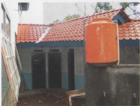
Tangki penampungan air plastik dengan pipa PVC
