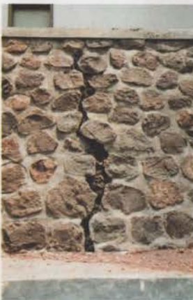
Dinding penyangga yang mengalami keretakan
