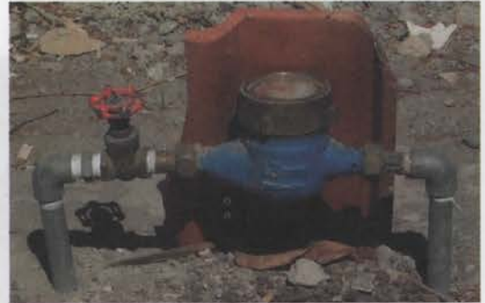
Alat kontrol penyaluran air induk ( stop cock )
