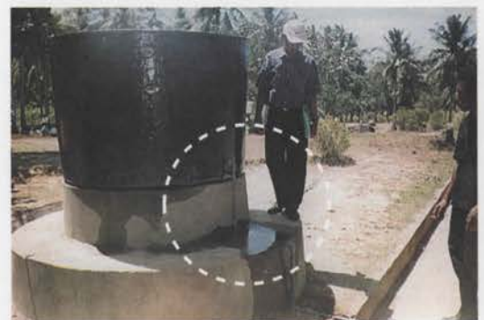
Tangki penampungan air yang menggunakan pipa besi
