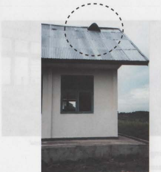
Lembaran atap metal yang lepas karena pemasangan yang kurang baik
