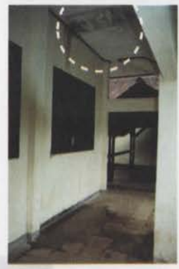
Plafond luar yang terkena tanda kelembaban akibat bocoran atap
