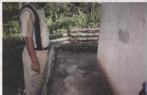
Paving blok yang retak dan pecab
