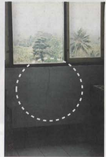
Retakan-retakan kecil pada dinding.
