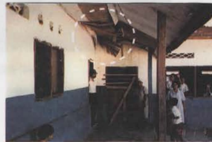
Plafond luar yang rusak
